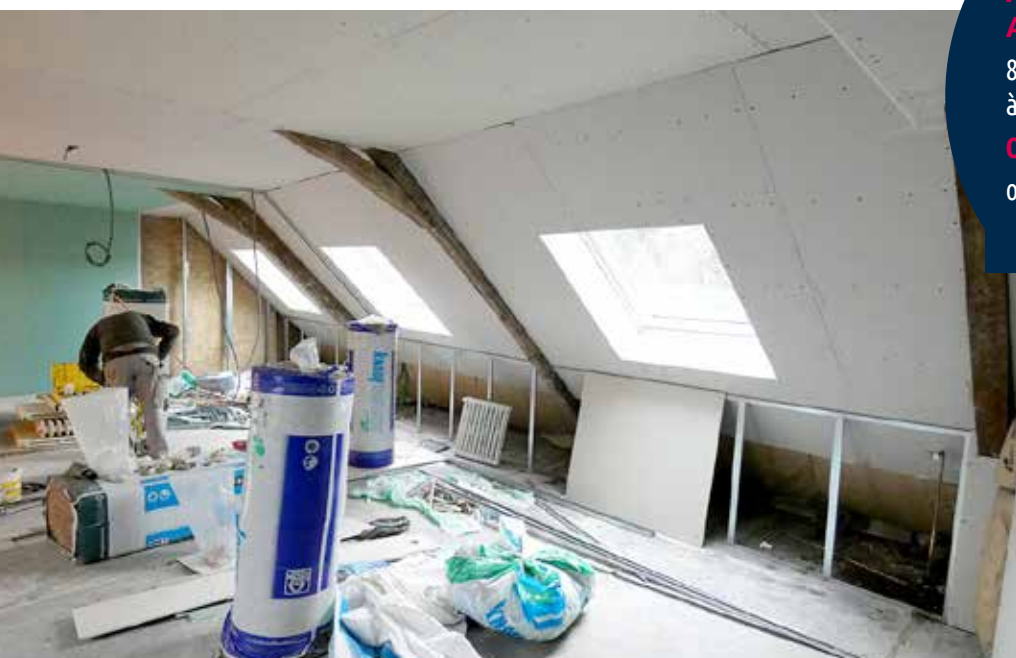
L'isolation est un point essentiel pour diminuer sa consommation d'énergie.
